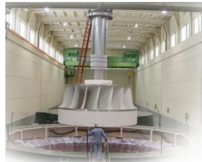
figure 7 turbine d'une centrale hydroélectrique
